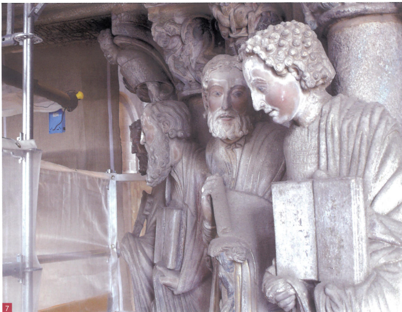
7. La humedad y las sales se manifiestan más en unas figuras que en otras, dependiendo de su ubicación.
